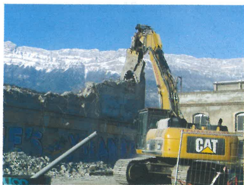
Pont de Claix – Démolition des Papeteries de Pont de Claix – 8,5 ha – Projet mixte habitat/économie de renouvellement urbain – La Métro – Com. Agglo Maîtrise d'ouvrage epfl du dauphiné : désamiantage, déconstruction et dépollution – Portage epfl du dauphiné.
